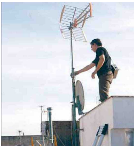
Un instal·lador de la TDT a la Canonja, a Tarragona, en l'apagada del 2010 ■ JUDIT FERNÁNDEZ
