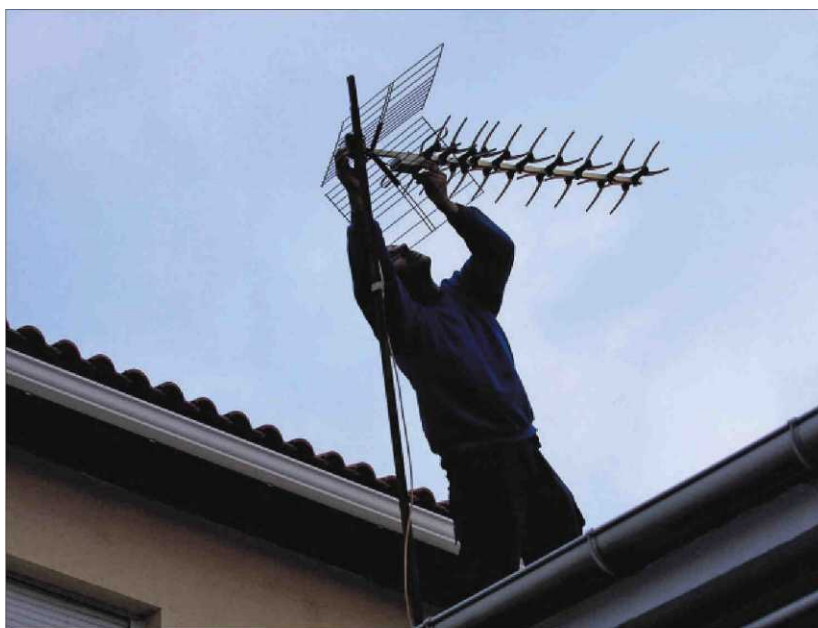
Un millón de edificios tienen que adaptar las antenas colectivas. / SANTI BURGOS
